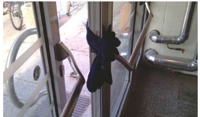
Leider funktionieren nach der Sanierung nicht alle Dinge von Anfang an, wie man an der Vordertür sieht. Ein Schal verhindert, dass die Tür sich unkontrolliert schließt und dann von außen nicht mehr zu öffnen ist.
